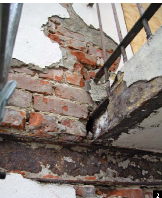
Abb. 2: Nur wenn man die Wand öffnet, kann man den Zustand der Stahlträger bestimmen. Meist sind sie bereits stark korrodiert.
