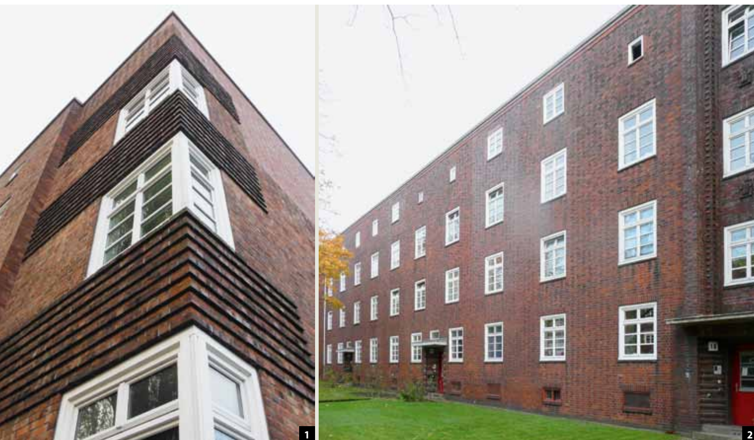
Abb. 1/2: Auf den ersten Blick nicht zu erkennen: Etwa die Hälfte der denkmalgeschützten Backsteinfassaden des Hamburger Wohnblocks hatten kaum noch einen Verbund zum dahinterliegenden tragenden Mauerwerk.
